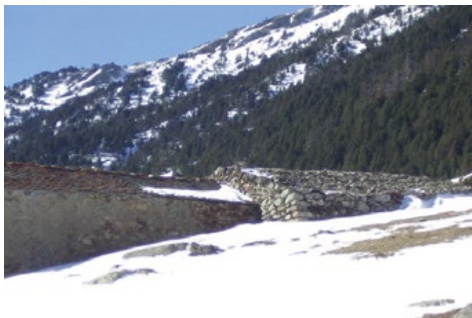
Estructura destinada a trencar allaus en una borda de la vall d'Incles.
